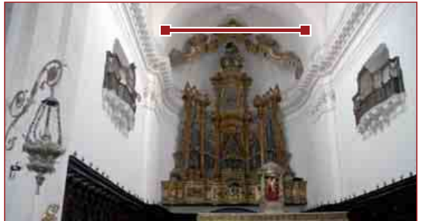
Il tirante che andrebbe posto alla base dell'arco dell'abside, a 12-14 metri di altezza, incatenandone i due estremi. Questo sistema di messa in sicurezza, così come quello dei contrafforti, serve a contrastare le spinte oblique cui danno luogo le strutture curve
